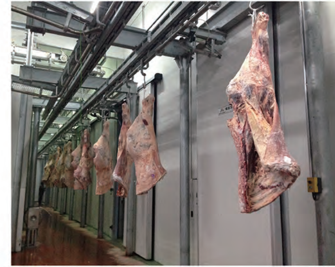
Chiller auto conveyor with optional software 预冷自动线轨道, 可选软件控制
