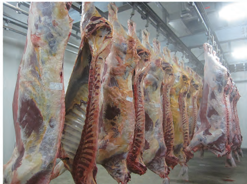
Chiller manual rail 预冷手推线轨道
